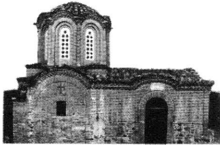
Ο ναός του Σωτήρα στην Εγνατία, που καταστράφηκε κατά την διάρκεια του σεισμού του 1978. Τα τοιχάρια είναι κρυμμένα από το σπασμένο στέγαστρο.
