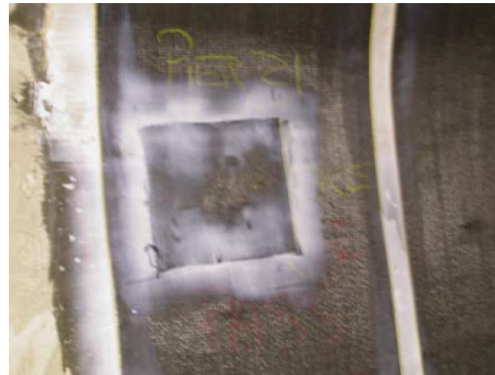
(d) Repaired air void defect
